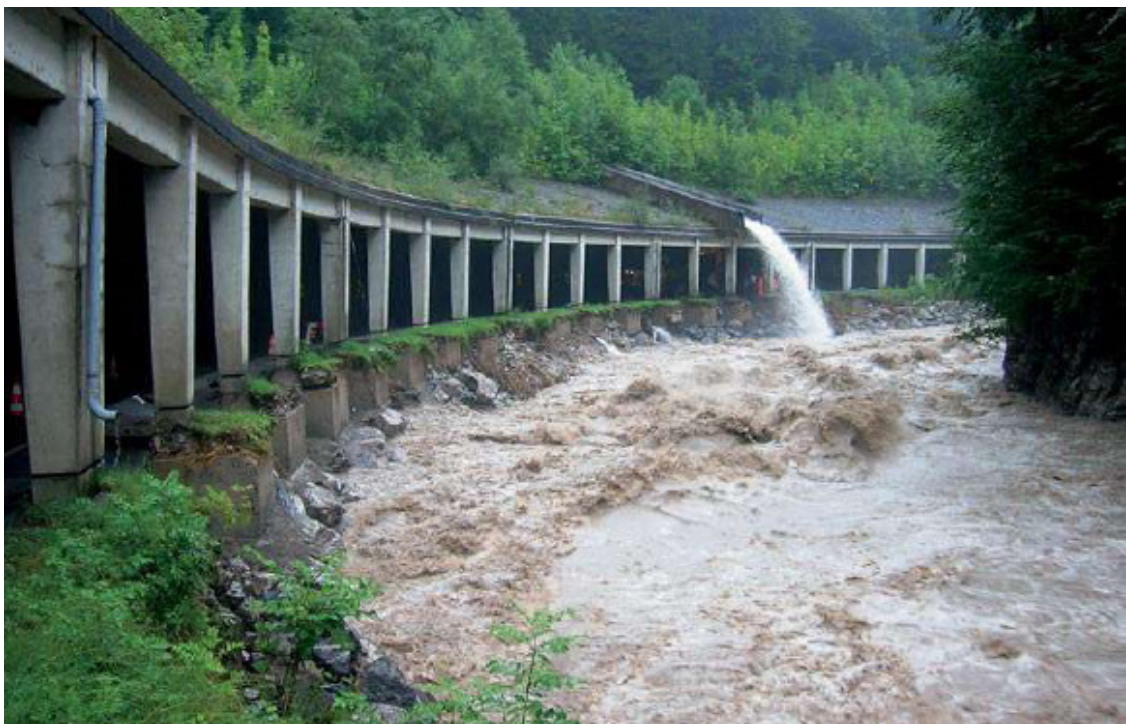
Abbildung 21: Die beschädigte Klausernald - Galerie
