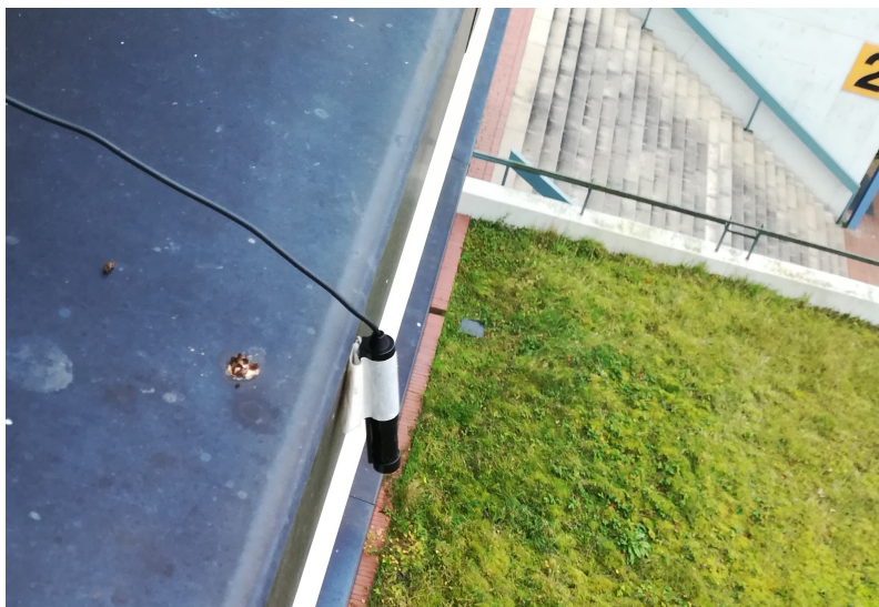
Abbildung 3.3: Das Mikrofon des Sensors al_01 an der Außenwand des Gebäudes.
