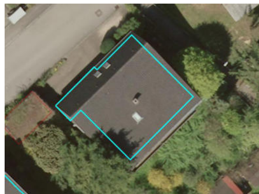
Abbildung 58: Dachfläche ohne Kiesbelag in der Aufnahme aus dem Jahr 2016
