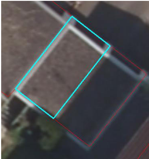
Abbildung 63: Dachfläche mit unterschiedlich eingeschätztem Kiesanteil, Aufnahme aus dem Jahr 2011 (1)
