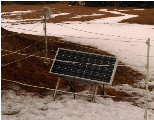
Abbildung 12: Solarpanel für die Stromversorgung
