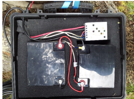
Abbildung 13: Akkumulator Solarstrom und Kameraversorgung
